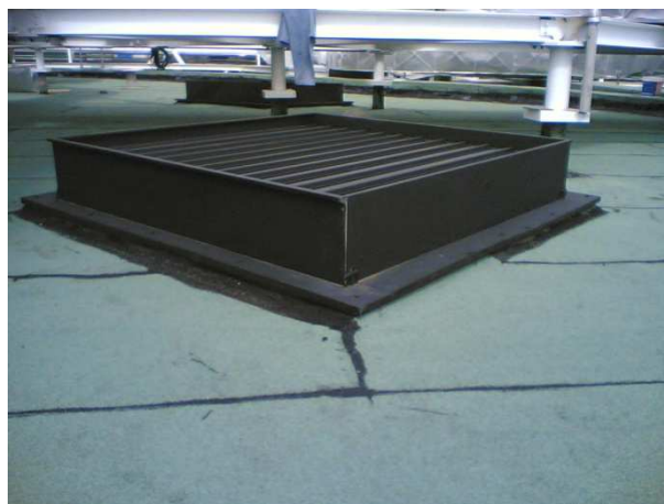
Encontro da impermeabilização contra um escoadouro com pouca altura. Dever-se-ão adoptar medidas correctivas imediatas.
