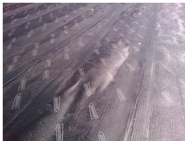
Bolsas entre o sistema de impermeabilização e o suporte
