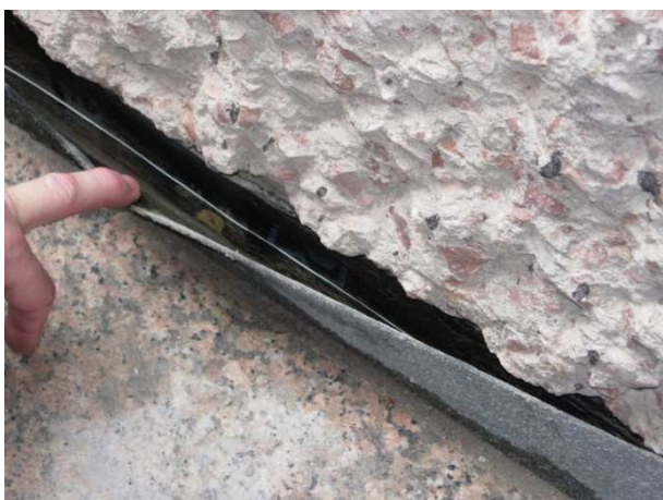
Altura inadequada no remate da impermeabilização contra um elemento vertical, assim como falta de aderência ao mesmo. Devem-se adoptar medidas correctivas imediatas.
