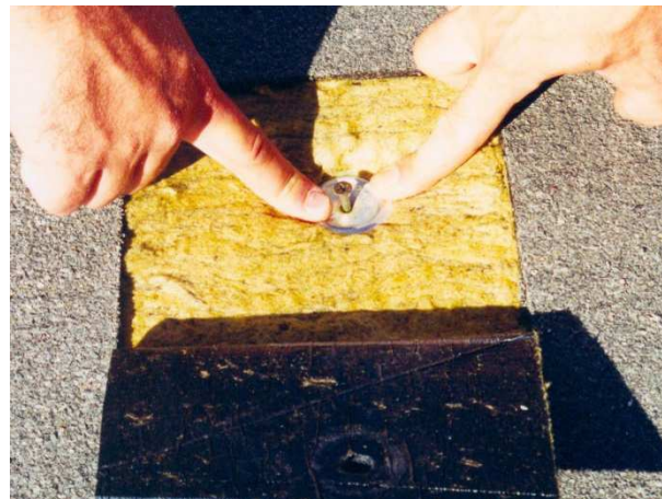
Fixação inadequada que originou o punção do sistema de impermeabilização.
