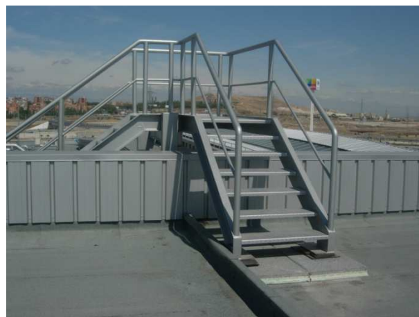
Apoio de escada metálica mediante elementos de reforço para se evitem danos na membrana impermeabilizante.
