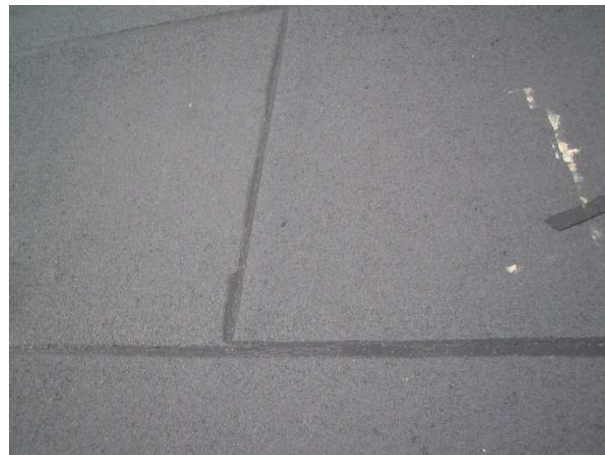
Retracção de sobreposição longitudinal e transversal.
