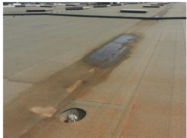
Caleira com acumulação de água na proximidade dos ralos
