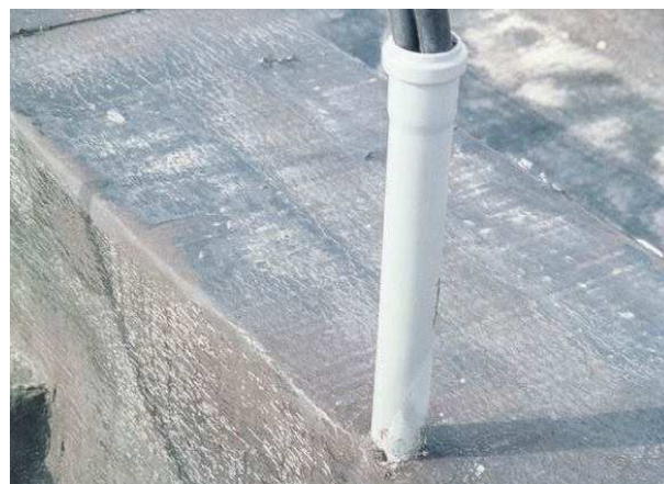
Remate da impermeabilização com passagens de condutas sem peças especiais adequadas.
