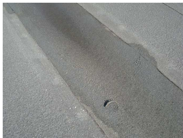
Perda de grânulos de ardósia
