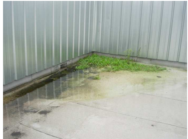
Estado da cobertura num edifício próximo de zonas com muita vegetação, onde não foram efectuadas visitas periódicas de inspecção.
