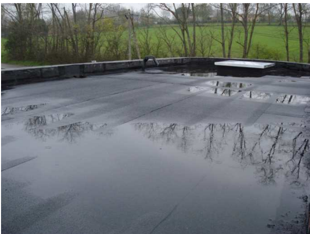
Cobertura em que se verifica acumulação de água.
