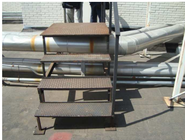
Apoio de elementos sobre a impermeabilização sem qualquer elemento de protecção. Deverão ser empreendidas acções correctivas imediatas.
